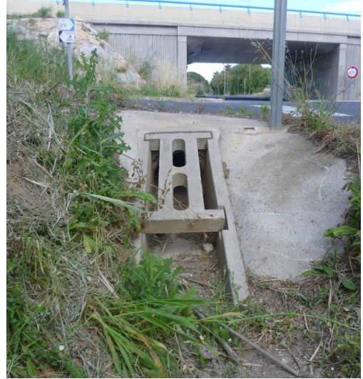
Buse de franchissement avec tête d'aqueduc
